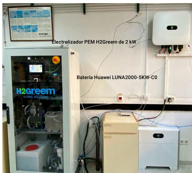
Fig. 2.4. Sistema de almacenamiento compuesto por un electroizador PEM H2Greem de 2 kW y una batería fotovoltaica Huawei LUNA2000-5KW-C0 con capacidad de 5 kWh.
