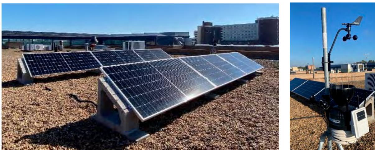
Figura 2.1. Instalación PV de 2,79 kW ubicada en la cubierta de la Escuela de Ingenierías Industriales de Badajoz, Universidad de Extremadura.
