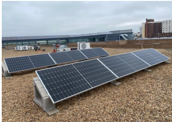
Figura 8. Foto de la instalación real ubicada en la cubierta de la Escuela de Ingenierías Industriales (Universidad de Extremadura).
